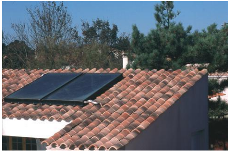
Capteurs solaires intégrés sur toiture neuve, Chéray
